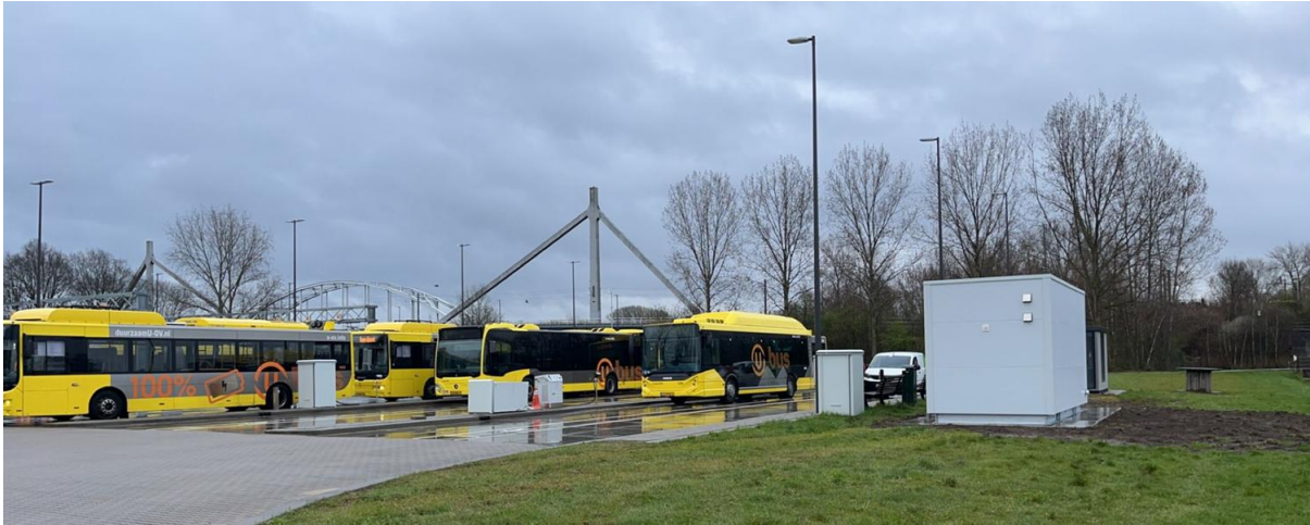
Figuur 27 Container met refurbished batterij op de laadremise voor e-bussen van Qbuzz in Utrecht.
